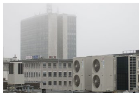
Außengeräte auf dem Dach
